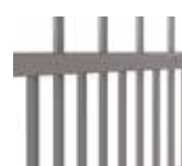
Espace réduit par rajout de tubes débordants et pointes dans le soubassement
